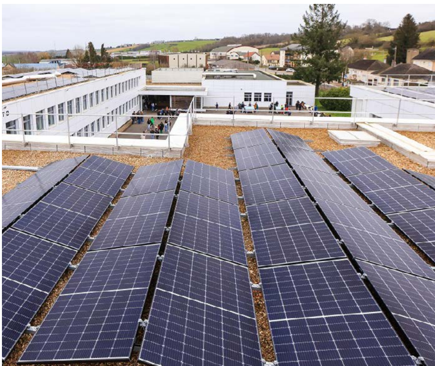
Panneaux photovoltaïques sur la toiture du collège de Morée.
