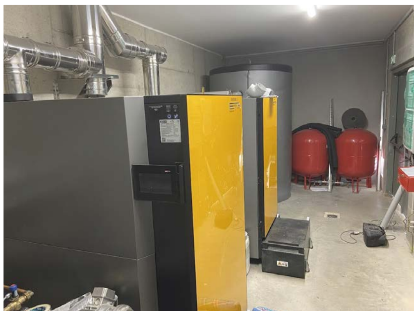
Chaufferie bois soutenue dans le cadre du dispositif DDAD.
